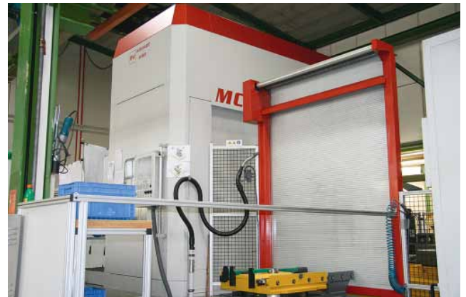
Die MCX 900 war auf Grund des geringen Platzbedarfes die einzige der untersuchten Maschinen, die ohne größere Umbauarbeiten in die vorhandene Halle integriert werden konnte.
